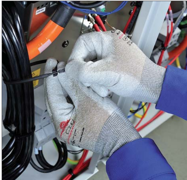
Incluso en circunstancias difíciles, las bridas Q-tie son muy rápidas y fáciles de aplicar.
