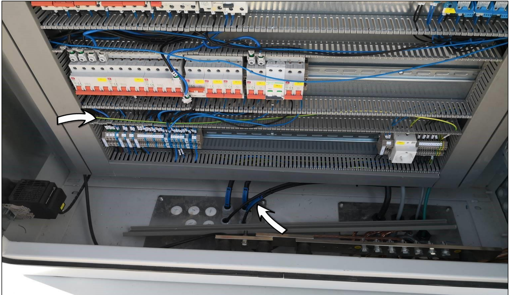
Canaletas ranuradas, identificación de cables, bridas y fijaciones, aislamiento, protección...
