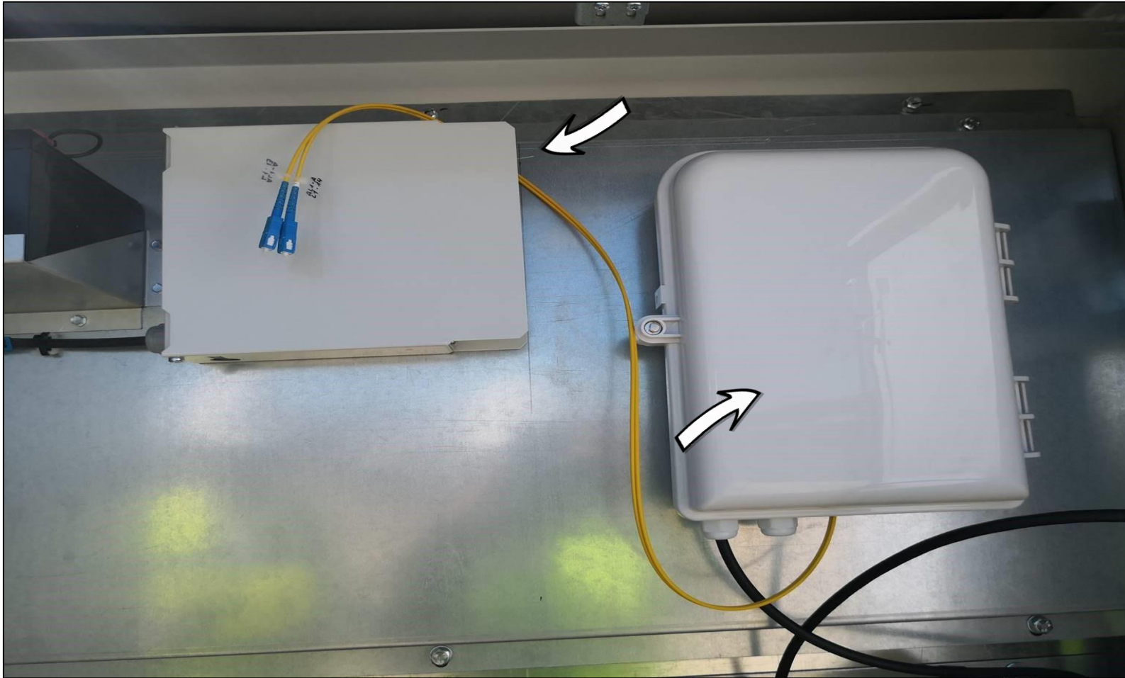
Latiguillo de fibra (Monomodo o Multimodo) dentro del inversor.
