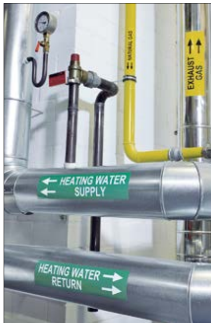
Marcaje de alta visibilidad para tuberías de gran longitud.
