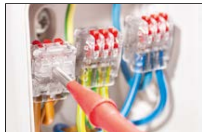
Toma de tensión en la parte inferior del conector.
