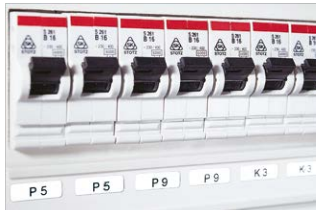
Identificación clara y permanente de paneles de control.
